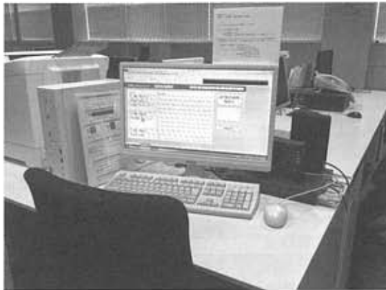
図8 遠隔監視システムモニタリング
